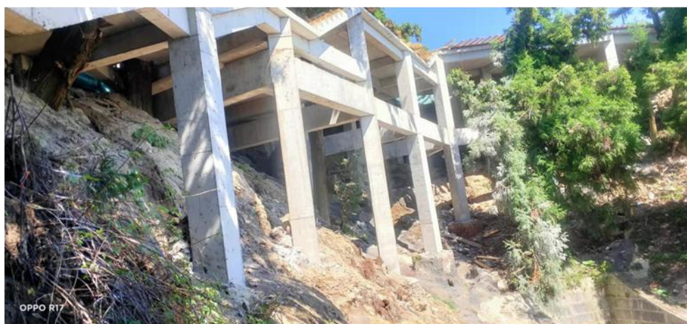
图 4.3.7-1 施工现场裸露桩基及裸土
